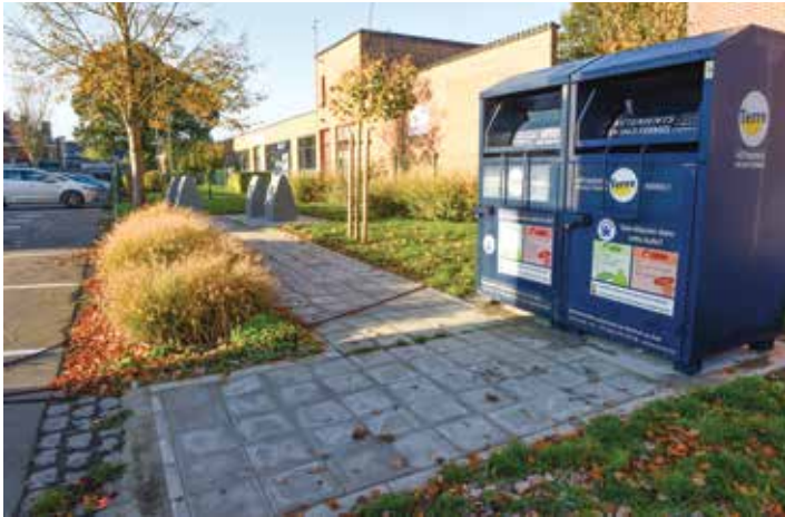
Réalisation d'une extension de trottoir à la Place à Baudet pour le déplacement des bulles à vêtements.
