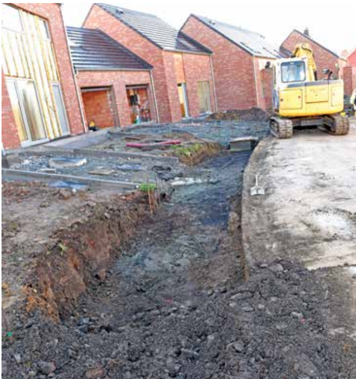
Pose d'un égouttage (environ 40 mètres) et construction d'une chambre de visite à la Place Croix Vasseau à Lanquesaint.
